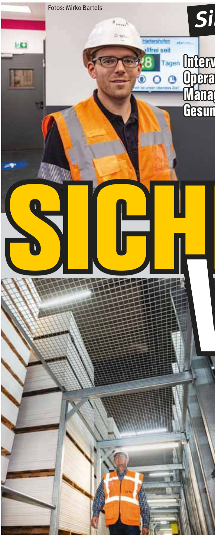
Mit diesem durch Schutzgitter von oben gesicherten Verkehrsweg sind stürzende oder herabfallende Lasten im Lager keine Gefahr mehr für die Fußgänger.
