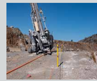
Die Bruchkante wird bei den Fels-Werken mit leicht einzusetzenden Aluminiumpfosten und schmutz- bzw. wasserabweisenden Nylonseilen gesichert.
