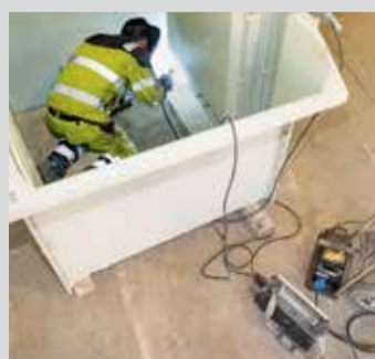
Schweißen in engen Räumen nur mit Trenntrafo, um eine Durchströmung zu vermeiden.
